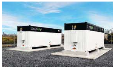
Batteriespeicher mit 2-3 MWh Kapazität
