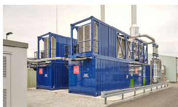
2 neue BHKW mit 800 bzw. 400 kW im Nachtbetrieb
